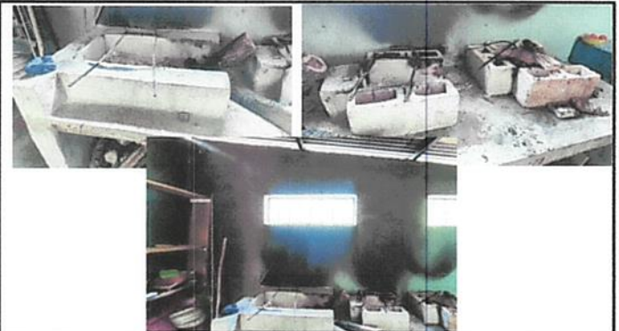
FOTO 2: ESTUFA IMPROVISADA Y NECESIDAD DE CHIMENEA
