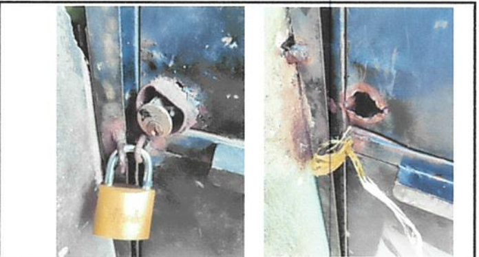
FOTO 4: CHAPAS EN MAL ESTADO
