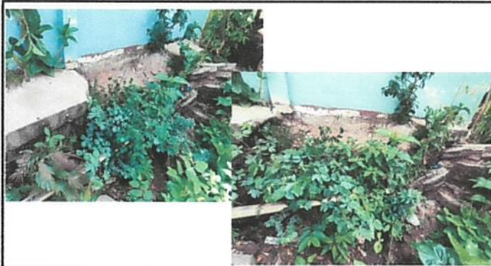
FOTO 3: MURO DE BLOCK Y BANQUETA CAÍDO
