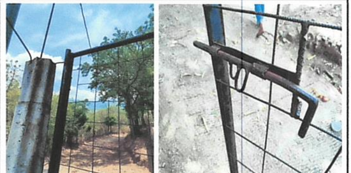
FOTO 6: PORTÓN DE INGRESO CON DEFICIENCIA EN SOLIDEZ Y SEGURIDAD
